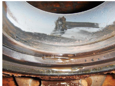
Smoorbus aangetast door putcorrosie.
