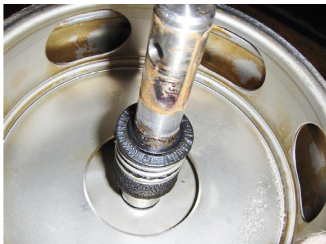
Glijvlak Mechanical Seal ingesleten.
